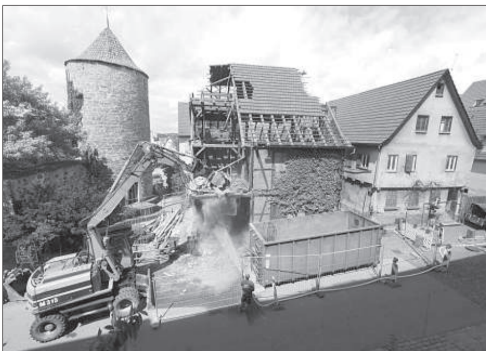
Die Scheune ist jetzt abgerissen, der Fußweg am Diebsturm kann wieder geöffnet werden. Bild: Privat
